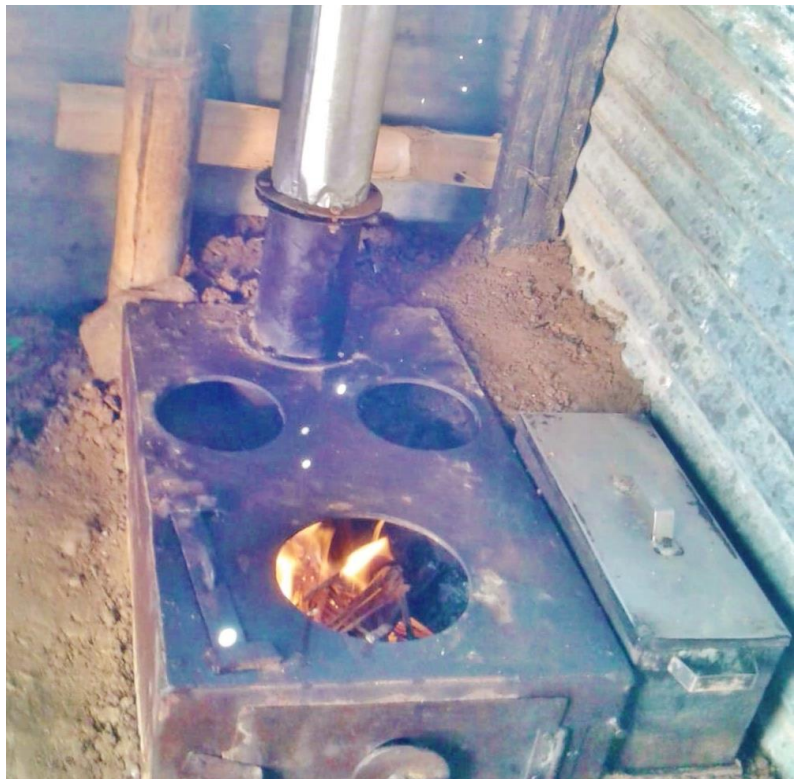
Neu installierter Ofen
